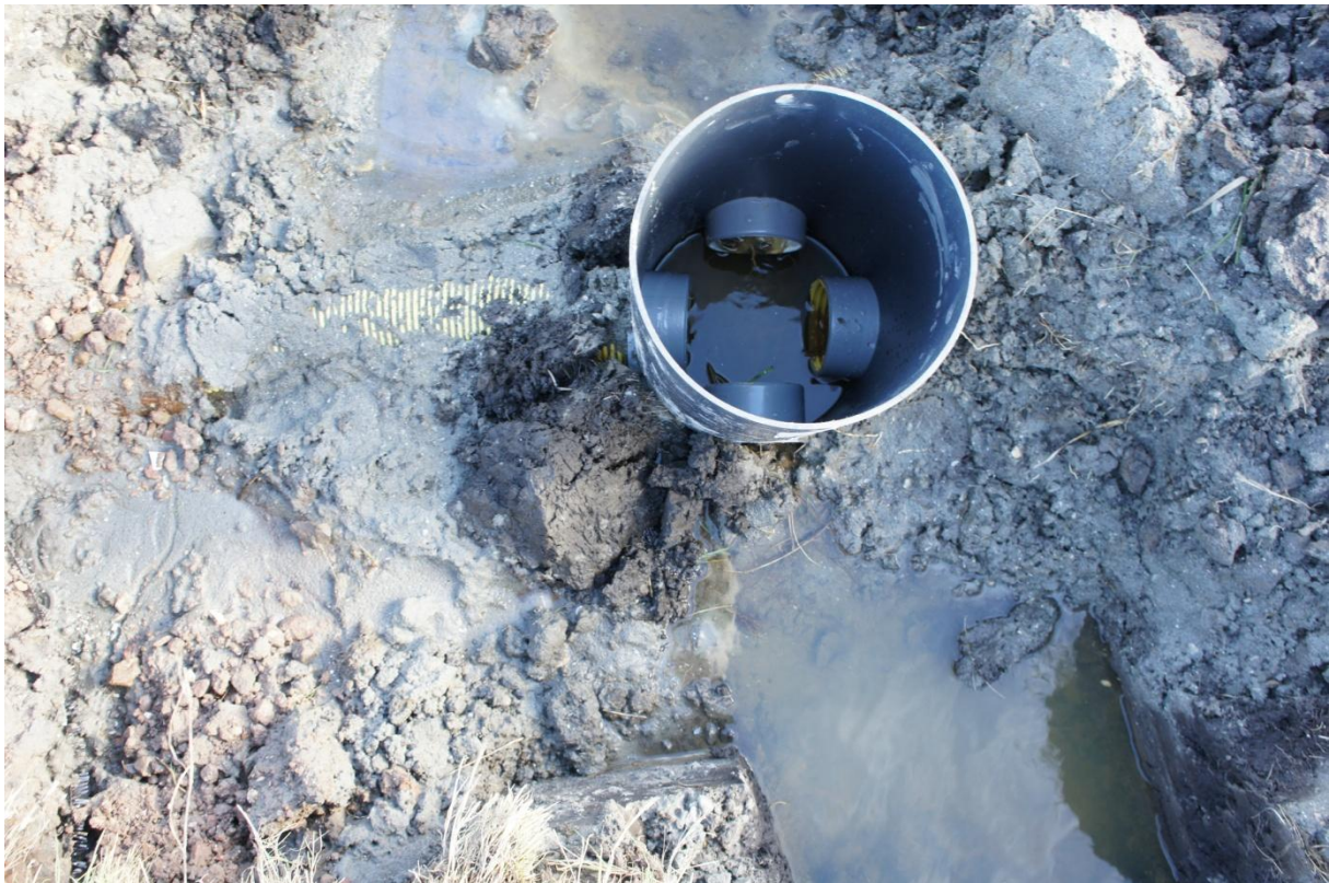
Foto 5. Detailopname van de ontwateringsbuizen met afvoer naar de sloot aan de zuidzijde (onderaan op de foto) van de tunnel.
