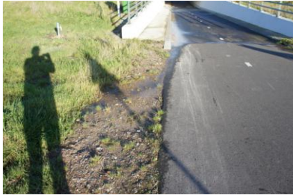
Foto 1. Stroom water aan de westzijde van de tunnel onder de metrolijn E op een droge en zonnige dag
